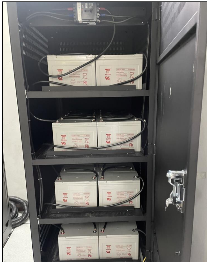
(圖十五)、 75 KVA-UPS 不斷電系統電池箱
