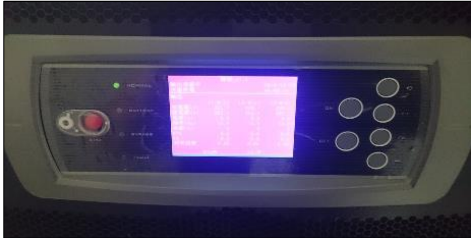
(圖十四)、 75 KVA-UPS 不斷電系統
